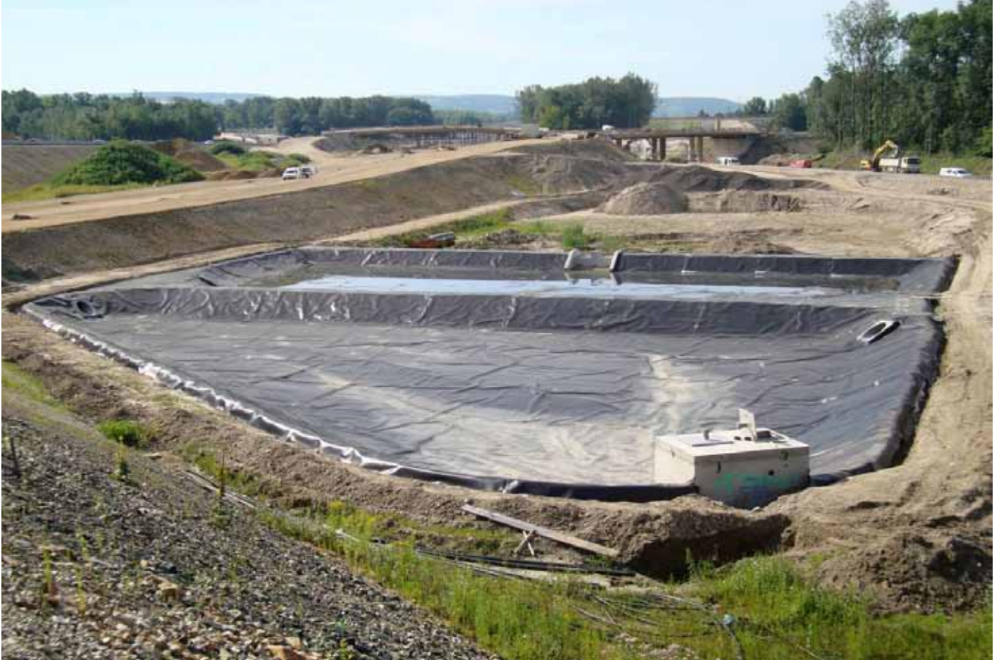
Gewässerschutzanlage Knoten Traismauer
